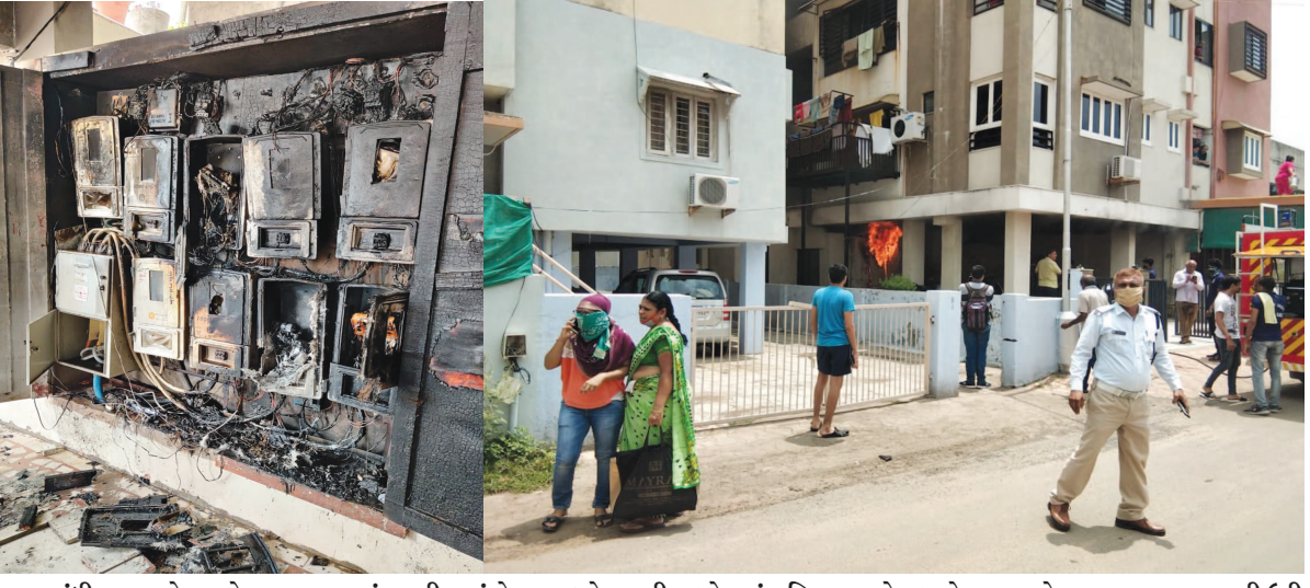
ગાંધીનગર શહેરના સેક્ટર-૨૨ આનંદ વાટીકામાં મેયરના ફલેટના મીટરબોક્ષમાં શનિવારના રોજ બપોરના સમયે અચાનક આગ ભભૂકી ઉઠી હતી. આગને પગલે ફલેટમાં રહેતા નાગરીકોમાં દોડધામ મચી ગઈ હતી. બનાવ અંગે ફાયર વિભાગને જાણ થતા ફાયર ઓફિસર મહેશ મોડ તાત્કાલીક ટીમ સાથે આવી પહોંચ્યા હતા. ફલેટના ભોંયતળીયે આવેલા મીટરબોક્ષમાં લાગેલી આગ પર પાણીનો મારો ચલાવી ગણતરીની મીનીટોમાં કાબુ મેળવી લીધો હતો. આનંદ વાટીકાના આ ફલેટમાં આવેલા ઈલેક્ટ્રીકના મીટરબોક્ષમાં શોર્ટસર્કિટ થવાને પગલે આગ લાગી હોવાનું મનાઈ રહ્યું છે.
