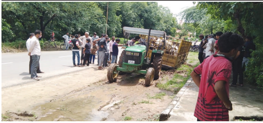
નગરના સે-પ ખાતે વસાહતીઓના ઘર પાસે ભૂગર્ભ પાઈપલાઈન નોંખવામાં આવી છે. પાઈપલાઈન નાખતી વખતે ખૂબ ઊંડાણથી ખોદકામ કરવામાં આવ્યું છે પરંતુ કામ પૂર્ણ થયા પછી બરાબર માટી પુરાણ કરવામાં આવ્યું નથી. જેને કારણે વરસાદના પાણી આ જગ્યા પર ભરાઈ જવાથી રોડ પાસે અવરજવર કરવામાં સ્થાનિકોને તકલીફ પડે છે અને નાના-મોટા અકસ્માત પણ થાય છે તેમ સે-પ વસાહત મંડળના પ્રમુખ કેસરીસિંહ બિહોલા જણાવે છે તથા સે-પના સ્થાનિકોની માંગ છે કે આ ખોદકામ તથા અવ્યવસ્થિત પુરાણને વ્યવસ્થિત કરવામાં આવે.
