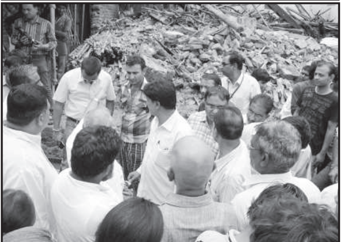
મહેસાણા શહેરના કર્મચારીઓએ આંબેડકર યોજનાના મકાન ધરાસાઈ થતા બેના કડુણ મોત નિપજ્યું હતું. આ ઘટનાની વિગત એવી છે કે મહેસાણા શહેરના કર્મચારીઓએ આંબેડકર યોજનાના મકાન ધરાસાઈ થતા બેના કડુણ મોત નિપજ્યું હતું. આ ઘટનાની વિગત એવી છે કે મહેસાણા શહેરના કર્મચારીઓએ આંબેડકર યોજનાના મકાન ધરાસાઈ થતા બેના કડુણ મોત નિપજ્યું હતું.
